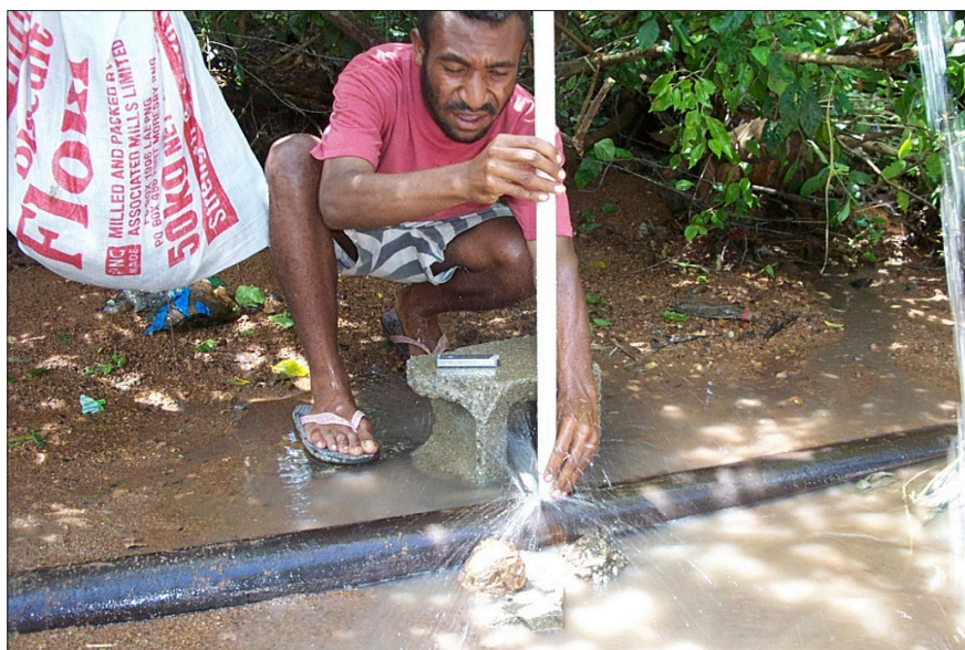
Fotografija 21: montiranje nelegalnega vodovodnega priključka. Foto: John Muke, Port Moresby, urbano naselje Eight Mile. Vir: Muke in Gonno 2002a: 59.
