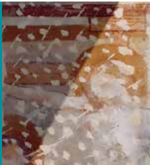
Slika 8: Primer detajla stenske slike, na kateri poškodbe povzročajo motnje v zaznavanju oblik in hkrati silijo v ospredje v obliki, ki spominja na snežne padavine (del stenske slike je v senci). Osebni arhiv in foto: B. Šeme.
